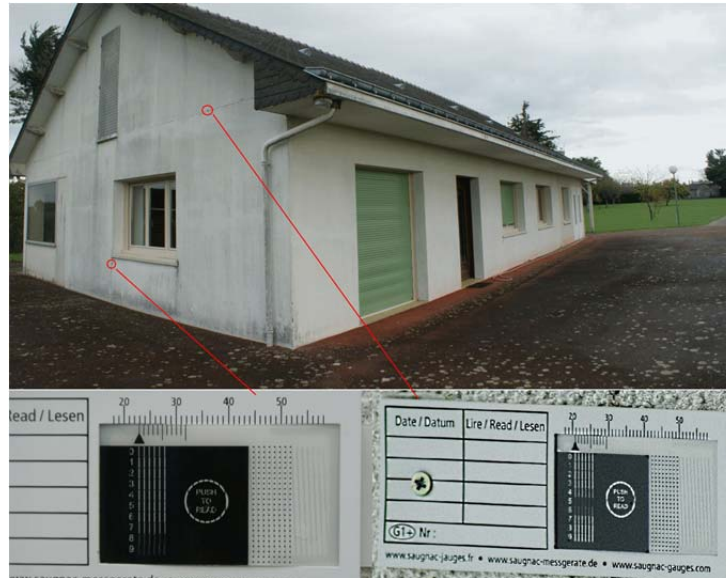
Illustration 7 - Lecture des fissuromètres.
