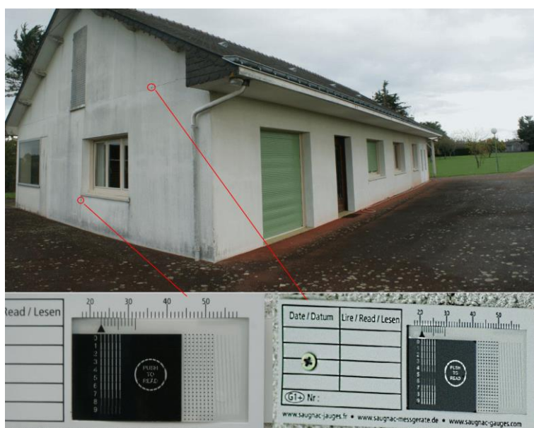
Illustration 7 - Lecture des fissuromètres.
