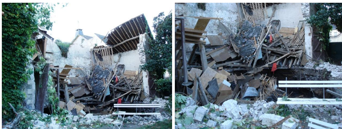
Illustration 13 - Vue de l'effondrement.
