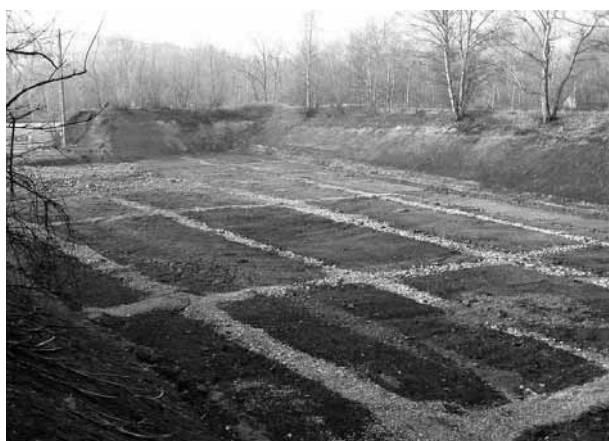
Photo 4. Réseau de drains en fond du bassin de décantation BD2 (cliché Jean-François Thomassin, BRGM).
