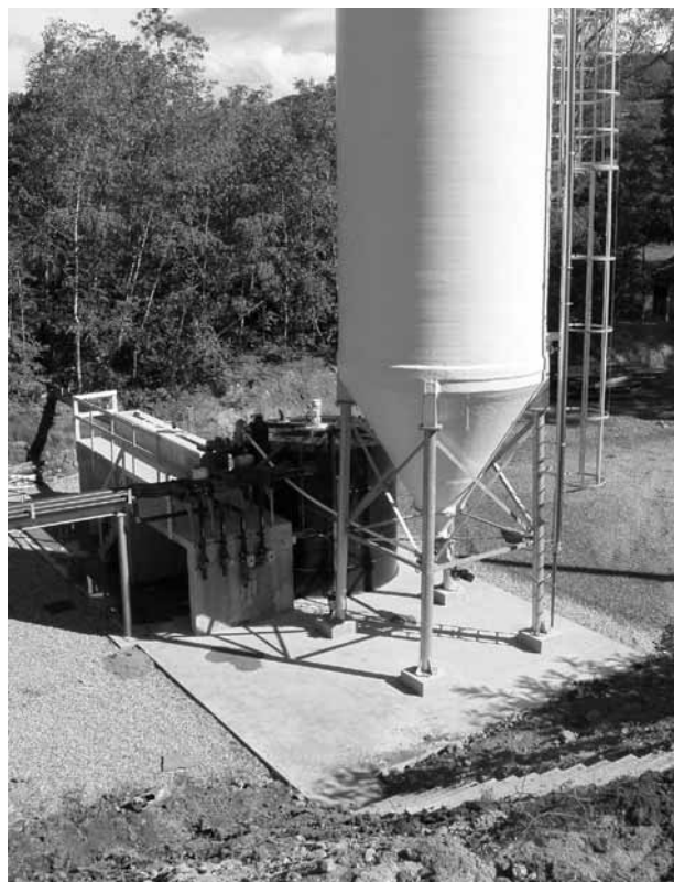
Photo 5. Vue d'ensemble de la nouvelle station (cliché Françoise Aye-Barthélémy, BRGM).
