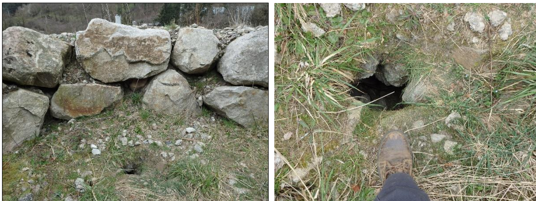
Illustration 35 : Dépôt de Côte Gravelle à Roche-la-Molière (42) - Trous observés sur le plateau au pied de l'ancienne zone d'éboulement du talus nord-ouest (avril 2019).
