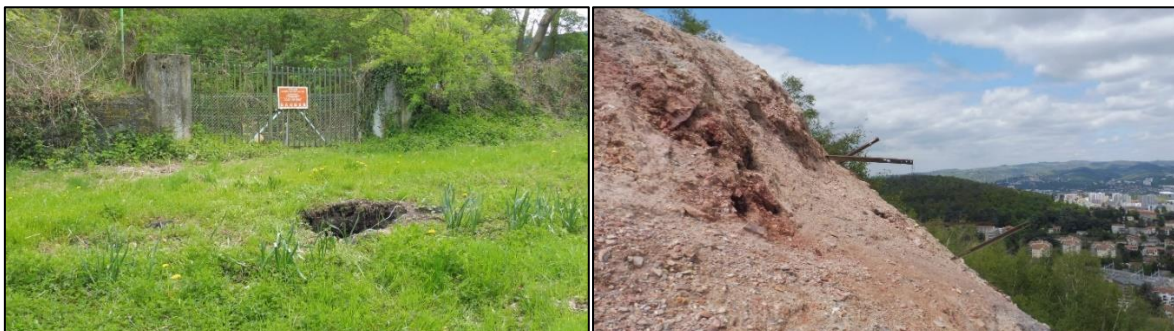
Illustration 23 : Terril Couriot B à Saint-Étienne (42) – probable fontis (à gauche) et fissure d'échauffement (à droite) au niveau du rampant – prises de vue mai 2019.
