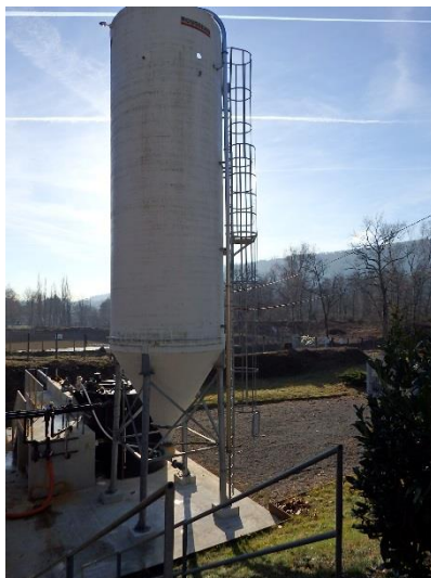
Illustration 42 : Station de traitement des eaux minières de Chessy-les-Mines (69) - Vue de l'unité de chaulage.
