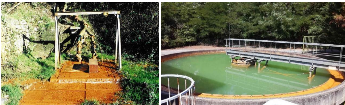
Illustration 8 : Pompage de la Perruquette (à gauche) et décanteur - épaisseur (à droite).
