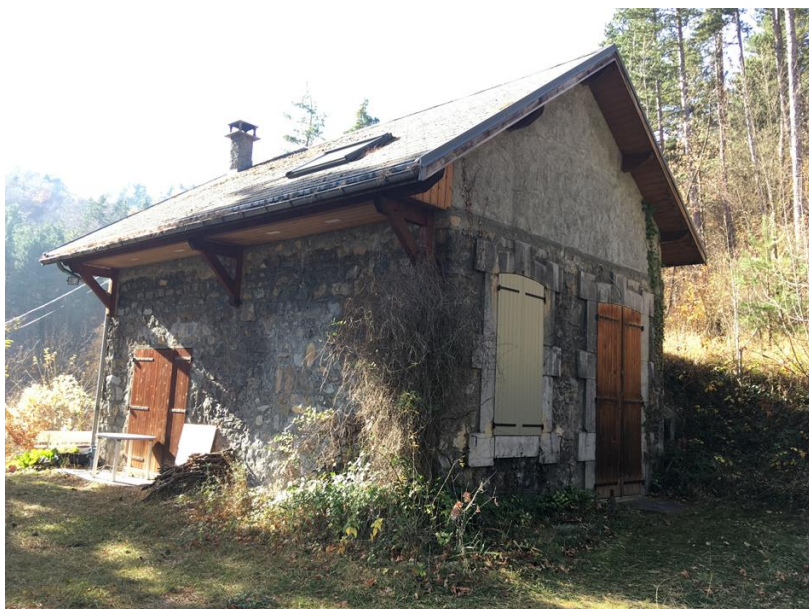
Illustration 14 : Susville (38) - Habitation individuelle au droit d'une galerie minière en mauvais état.
