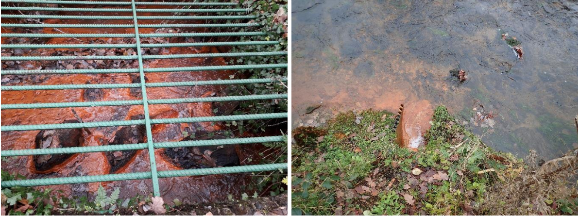
Illustration 93 : Canalisation - Inspection du puits Sainte-Barbe et du point de rejet dans la Sioule.
