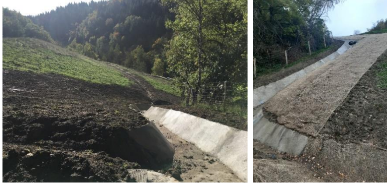
Illustration 103 : Talus régalés après coulage du fossé C' et toile de jute sur talus/fossé de risberme.
