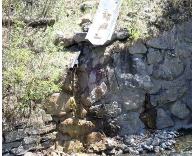
Illustration 47 : Émergence de Côte-en-Vélin à Fourneaux (73) – Écoulement des drains (mai 2019).
