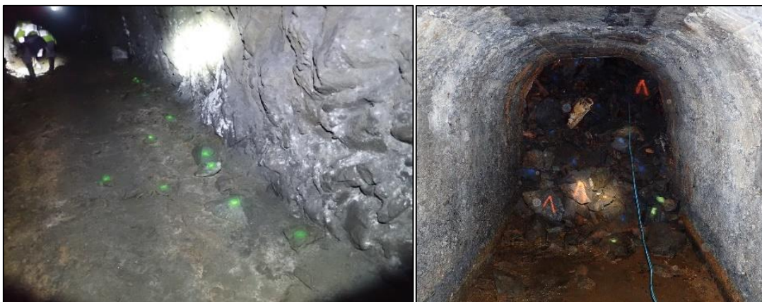
Illustration 51 : Blocs décimétriques tombés au sol (PM 80) à gauche, passage étroit obturé par de nouveaux blocs (PM 100) à droite.
