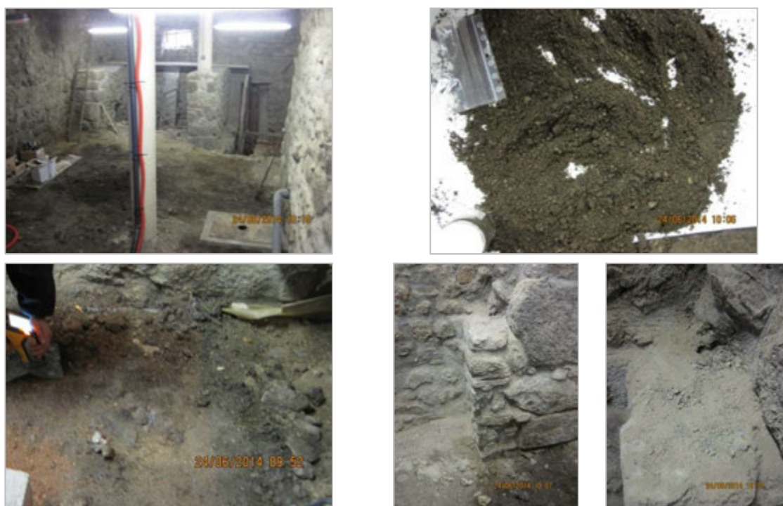
Figure 15 : Suies et cendres supposées dans la cave de la résidence 1 (INERIS, 2015)
